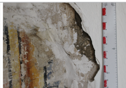
Mortero de cal sobre pintura mural Santo Domingo
